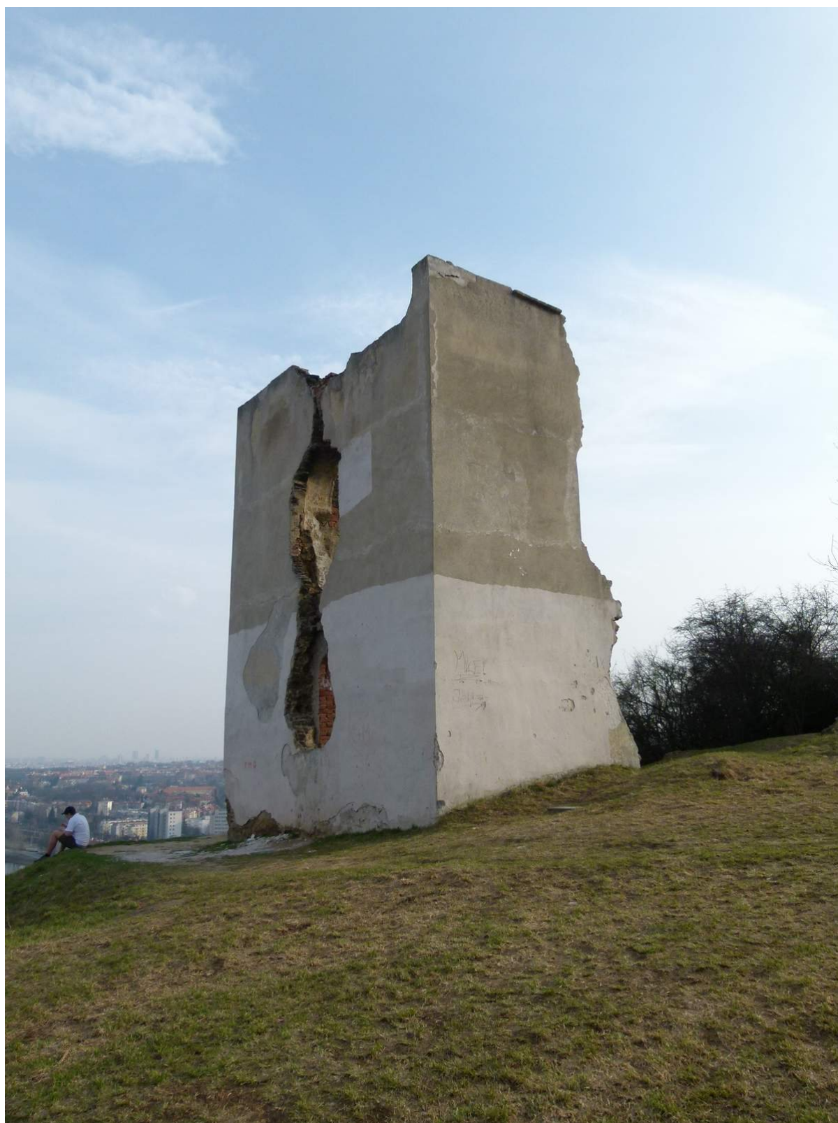
▲ Foto 05: Pohled na zříceninu od severu s trhlinou ve zdivu severovýchodní zdi.
