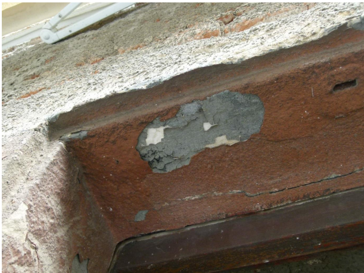
▲ Obr. 24: Stratigrafie nátěrů na kamenném ostění hlavního vstupu do domu. Starší středně šedý nátěr z roku 1927 překrytý mladším starorůžovým až červenohnědým nátěrem.
